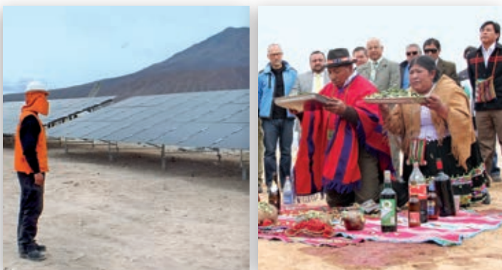
En 2014, El Abra se asoció con un desarrollador de energía renovable para instalar 1.500 paneles fotovoltaicos (izquierda) y una turbina eólica en la comunidad indígena de Ollagüe, Chile. Antes del proyecto, la comunidad sólo disponía de electricidad proveniente de generadores diésel. A la derecha, una ceremonia Quechua tradicional, denominada 'Pago a la Tierra', para dar gracias por el proyecto.
