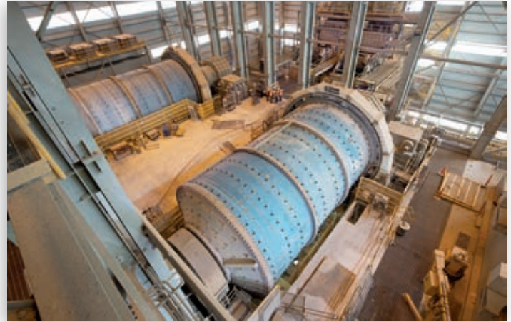
La expansión de la planta concentradora de Morenci en Arizona comenzó a operar en mayo de 2014. Como parte del proyecto, se instalaron molinos de bolas de alta eficiencia y un rodillo abrasivo hidráulico, lo que permite el procesamiento de mayores volúmenes de mineral con una eficiencia un 25% mayor que otros circuitos de chancado en la industria.
