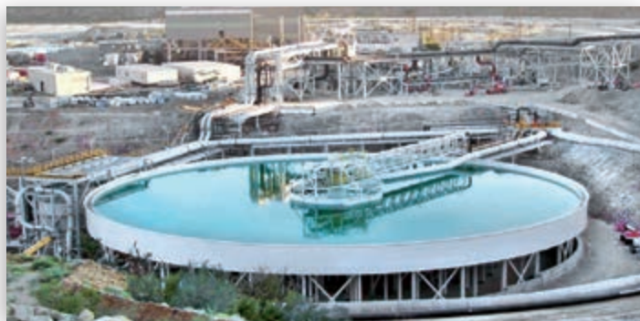
En 2013, la Mina Bagdad, en Arizona, terminó la construcción del espesador de relaves elevado más grande del mundo. Esta instalación permitirá la recuperación de grandes volúmenes de agua y la disminución de las filtraciones y las pérdidas por evaporación de la instalación de almacenamiento de relaves.
